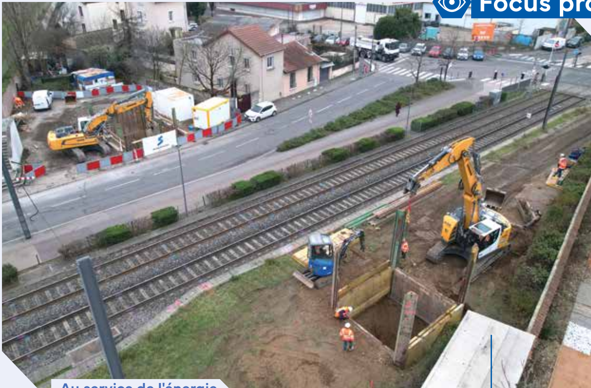
Au service de l'énergie
