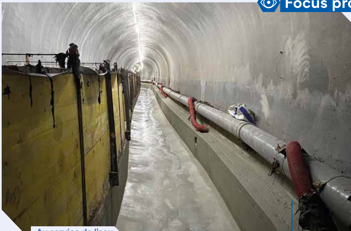
Au service de l'eau
