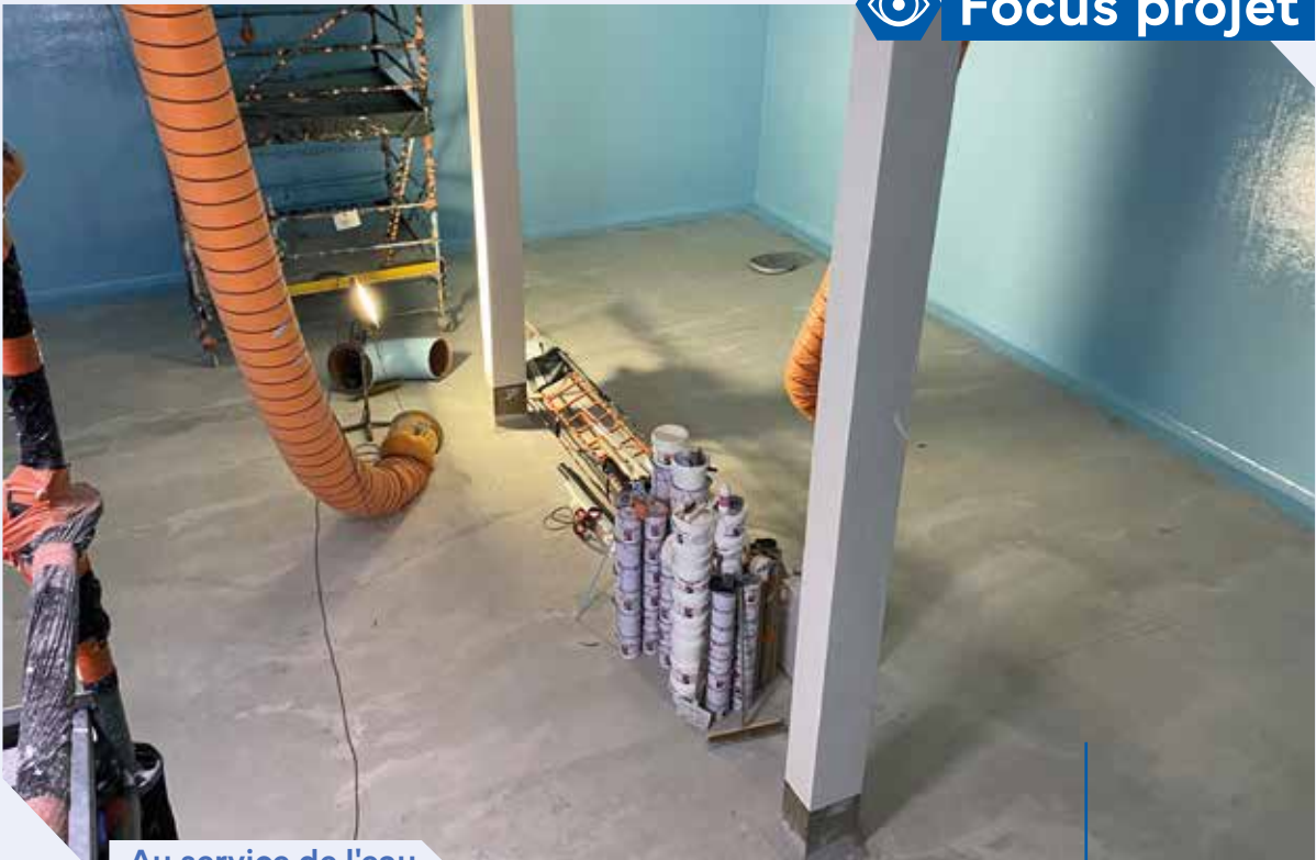
Au service de l'eau
