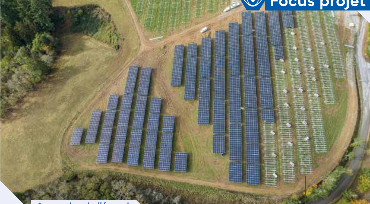
Au service de l'énergie
