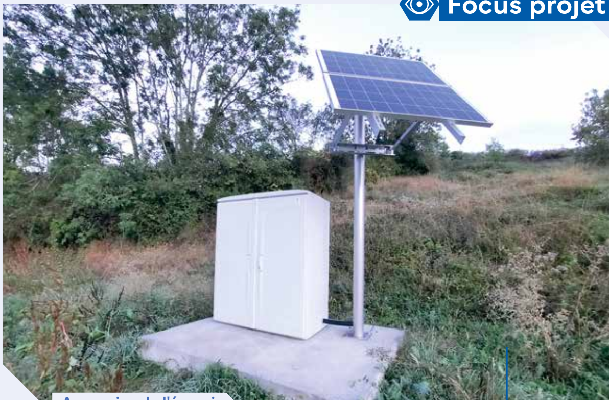
Au service de l'énergie
